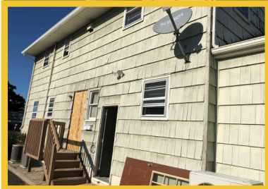
外墙材料需换新
